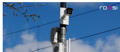
Datenbasierte Verkehrssteuerung mit SDS-Plattform und Sensorik: roosi unterstützt Kramsach auf dem Weg zur Smart City
