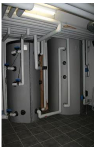
Wärmespeicher nach dem Doppel-Pufferspeicherkonzept (Foto: CC&S)
