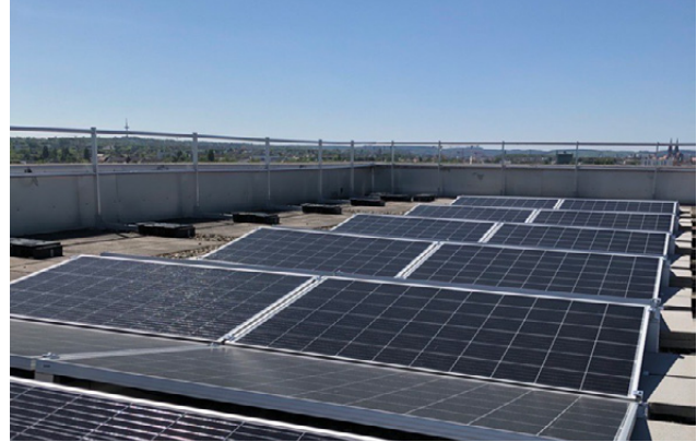
Photovoltaikanlagen auf dem Dach. Quelle: Continental AG
